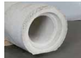
Betonmuffe ohne Dichtung
